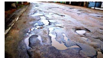
Рис.1. Дороги с ямами
